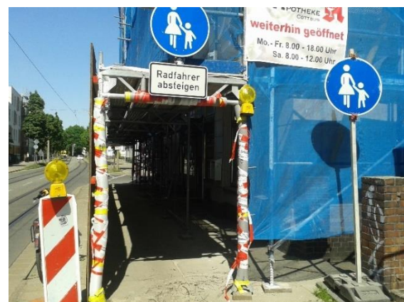
Abbildung 7: Bei Baustellen werden Radfahrende oft benachteiligt wie hier in Cottbus Foto: ADFC Cottbus
